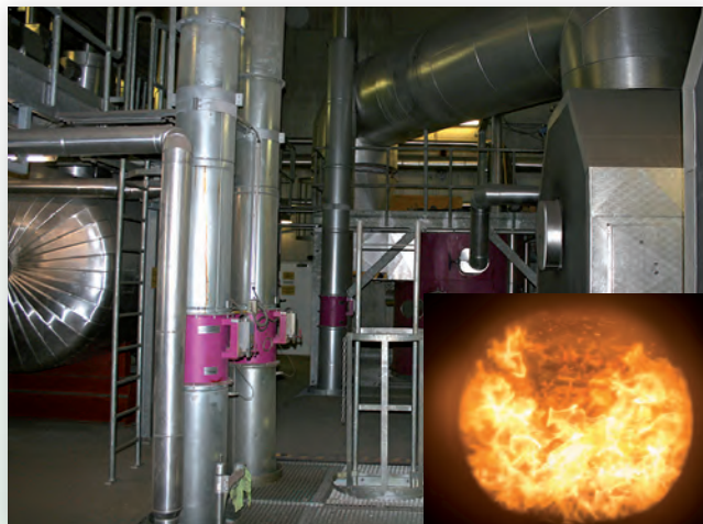
Das Holzkraftwerk Rastendorf produziert überwiegend aus Schadholz wetterunabhängig rund um die Uhr Strom und Wärme.
